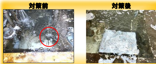
図19. クーリングタワー内部の対策前写真
